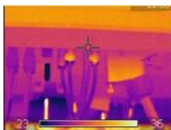
Figure 37 - Echauffement des branchements de câbles dans l'onduleur
